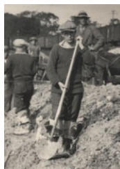
Jeune ouvrier travaillant à la réfection d'un quai à Saint-Jean-sur-Richelieu, en 1931 (détail).
